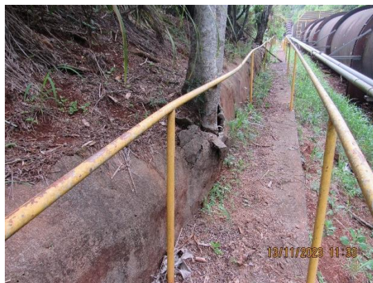
Figura 67 – Dano evidente a contenção do talude. Fonte: Cedro Inteligência Ambiental, Nov/2023.
