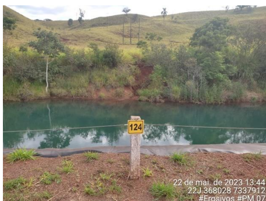
Figura 75 - Processo erosivo com cicatriz côncava, as margens do canal de adução. Talude de acesso recomposto. Fonte: Cedro Inteligência Ambiental, Mai/2023.
