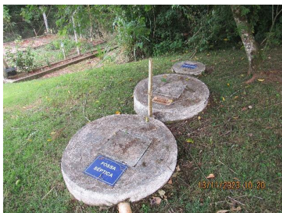
Figura 50 - Fossa séptica. Fonte: Cedro Inteligência Ambiental, Nov/2023.
