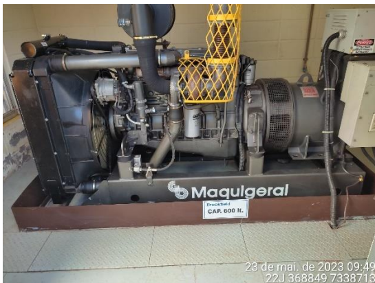
Figura 30 - Gerador diesel GMG. Fonte: Cedro Inteligência Ambiental, Mai/2023.
