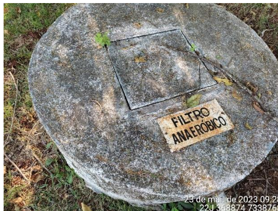
Figura 45 – Filtro anaeróbico. Fonte: Cedro Inteligência Ambiental, Mai, 2023.
