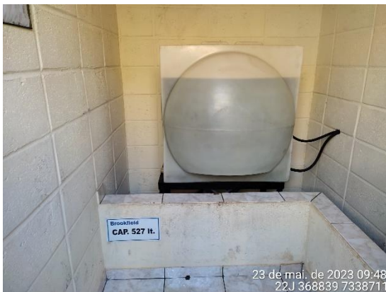
Figura 28 - Tanque do GMG. Fonte: Cedro Inteligência Ambiental, Mai/2023.
