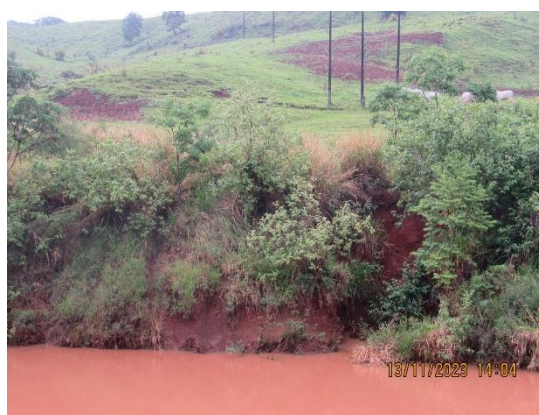
Figura 76 – Processo erosivo com cicatriz côncava, as margens do canal de adução. Talude de acesso recomposto. Fonte: Cedro Inteligência Ambiental, Nov/2023.
