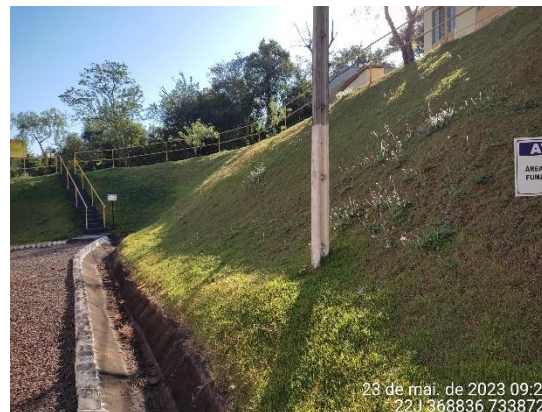
Figura 41 - Sistema de drenagem na área externa, talude ao lado do escritório. Fonte: Cedro Inteligência Ambiental, Mai, 2023.
