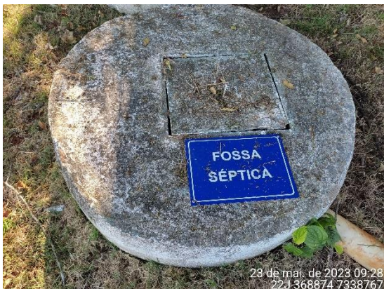
Figura 44 – Fossa séptica. Fonte: Cedro Inteligência Ambiental, Mai, 2023.
