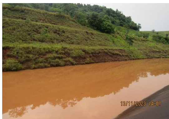
Figura 80 - Talude com porções de solo exposto. Fonte: Cedro Inteligência Ambiental, Nov/2023.
