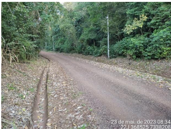
Figura 40 - Sistema de drenagem em ambos os lados da via. Fonte: Cedro Inteligência Ambiental, Mai, 2023.
