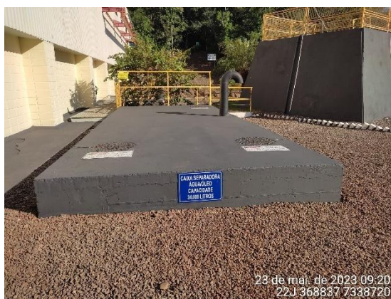
Figura 48 – Sistema separador de água e Óleo. Fonte: Cedro Inteligência Ambiental, Mai, 2023.
