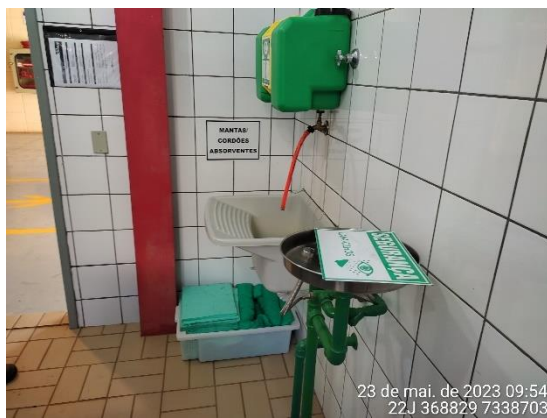
Figura 34 – Kit de mantas e cordões absorventes na área interna na sala de baterias. Fonte: Cedro Inteligência Ambiental, Mai/2023.
