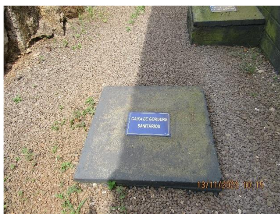
Figura 49 – Caixa de efluentes e caixa de gordura para tratamento primário de efluentes. Fonte: Cedro Inteligência Ambiental, Nov/2023.
