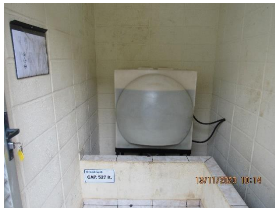
Figura 29 - Tanque do GMG. Fonte: Cedro Inteligência Ambiental, Nov/2023.
