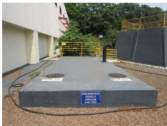
Figura 51 - Caixa separadora de água e óleo. Fonte: Cedro Inteligência Ambiental, Nov/2023.
