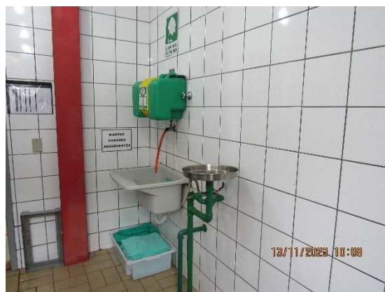
Figura 35 – Kit de mantas e cordões absorventes na área interna na sala de baterias. Fonte: Cedro Inteligência Ambiental, Nov/2023.
