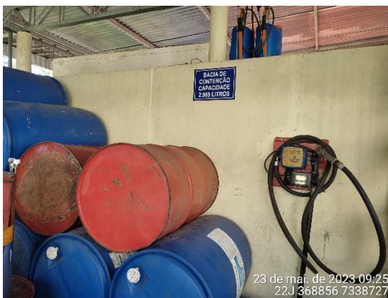
Figura 18 – Indicação da capacidade máxima da bacia de contenção do depósito de contaminantes. Fonte: Cedro Inteligência Ambiental, Mai/2023.
