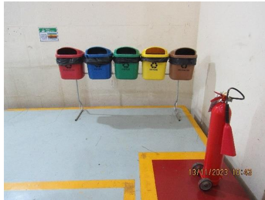
Figura 6 – Lixeiras seletivas situadas na área da galeria mecânica da SE. Fonte: Cedro Inteligência Ambiental, Nov/2023.
