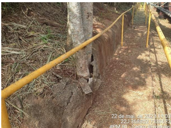
Figura 66 – Dano evidente a contenção do talude. Fonte: Cedro Inteligência Ambiental, Mai/2023.
